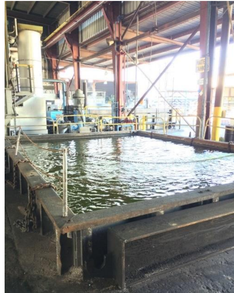
Tanque de Templado por Agua
