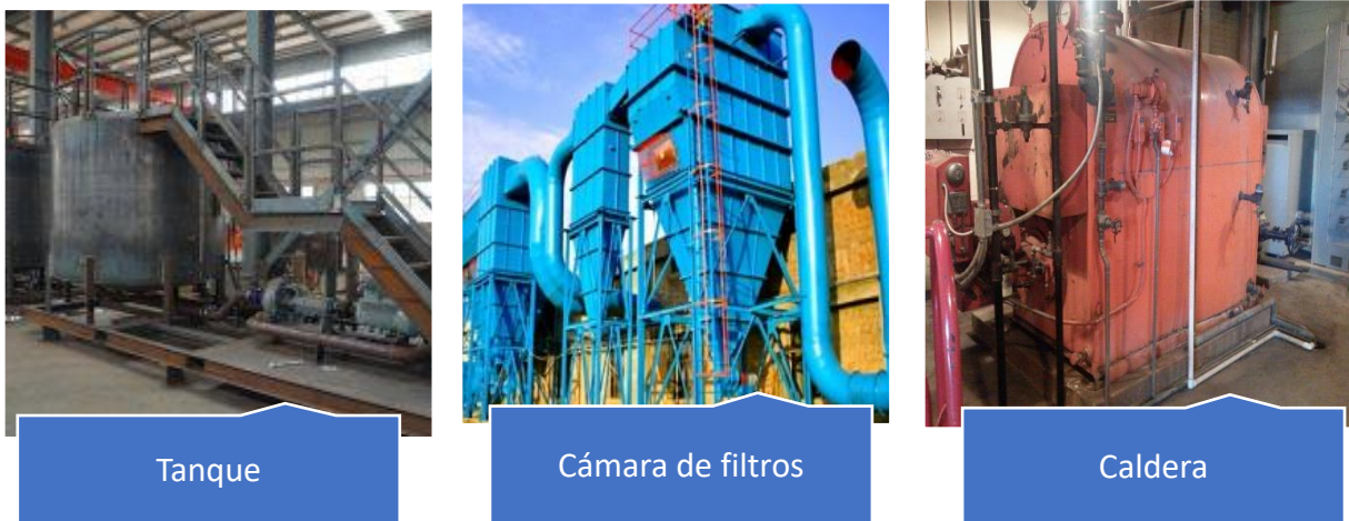
Figura 4-7: Ejemplos de Equipo de Instalaciones Generales Industriales
