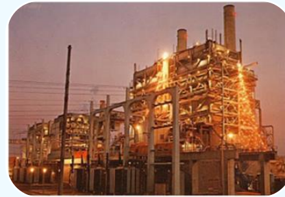
Instalaciones generadoras de electricidad
