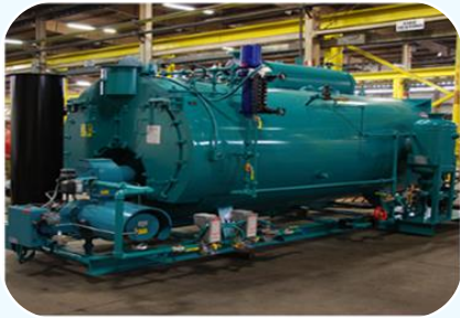
Calderas, generadores de vapor y calentadores
